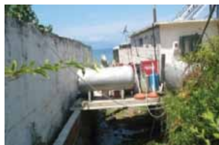
1-Shkarkimi I ujërave të bardha e të zeza të lagjes Uji I Ftohte, pranë ish Kampi I punëtorëve 2, 3-Shkarkimi i ujërave të bardha e të zeza të Lagjes Uji I Ftohte në Plazhin e Ri pranë lokalit "SAN TROPE"
