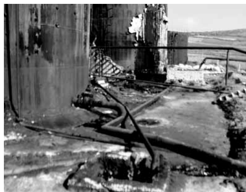
Fig. 3 Impianti i dekantinit Kash
